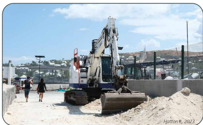
Sédiments accumulés devant une infrastructure portuaire
